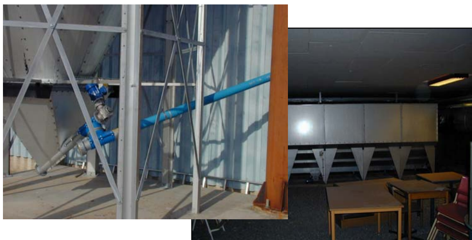
Rys. 10.7: Silos na pelety i przenośnik ślimakowy
