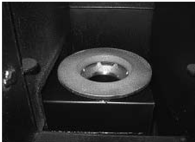
Komora spalania kotła bardzo czysta.
