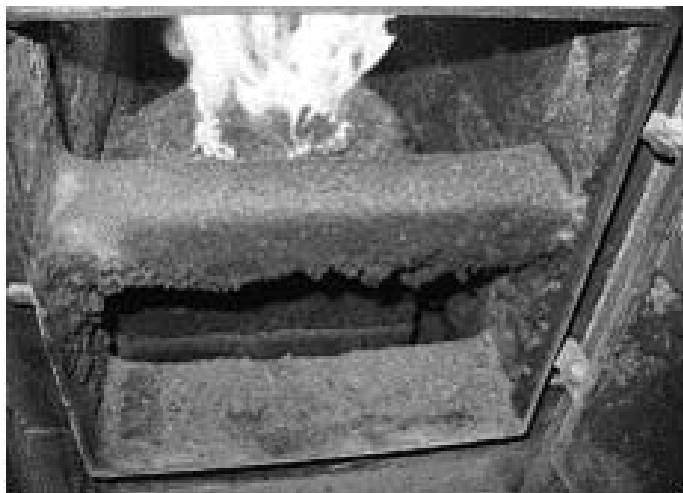
Komora spalania kotła bardzo brudna.
